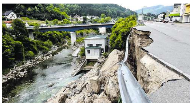
Die Ursache für den massiven Hangrutsch ist noch völlig unklar
